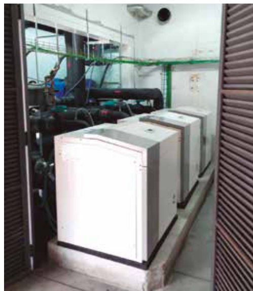
Gráfico 5-27. Caso de éxito diez. Foto de sala de máquinas de geotermia
